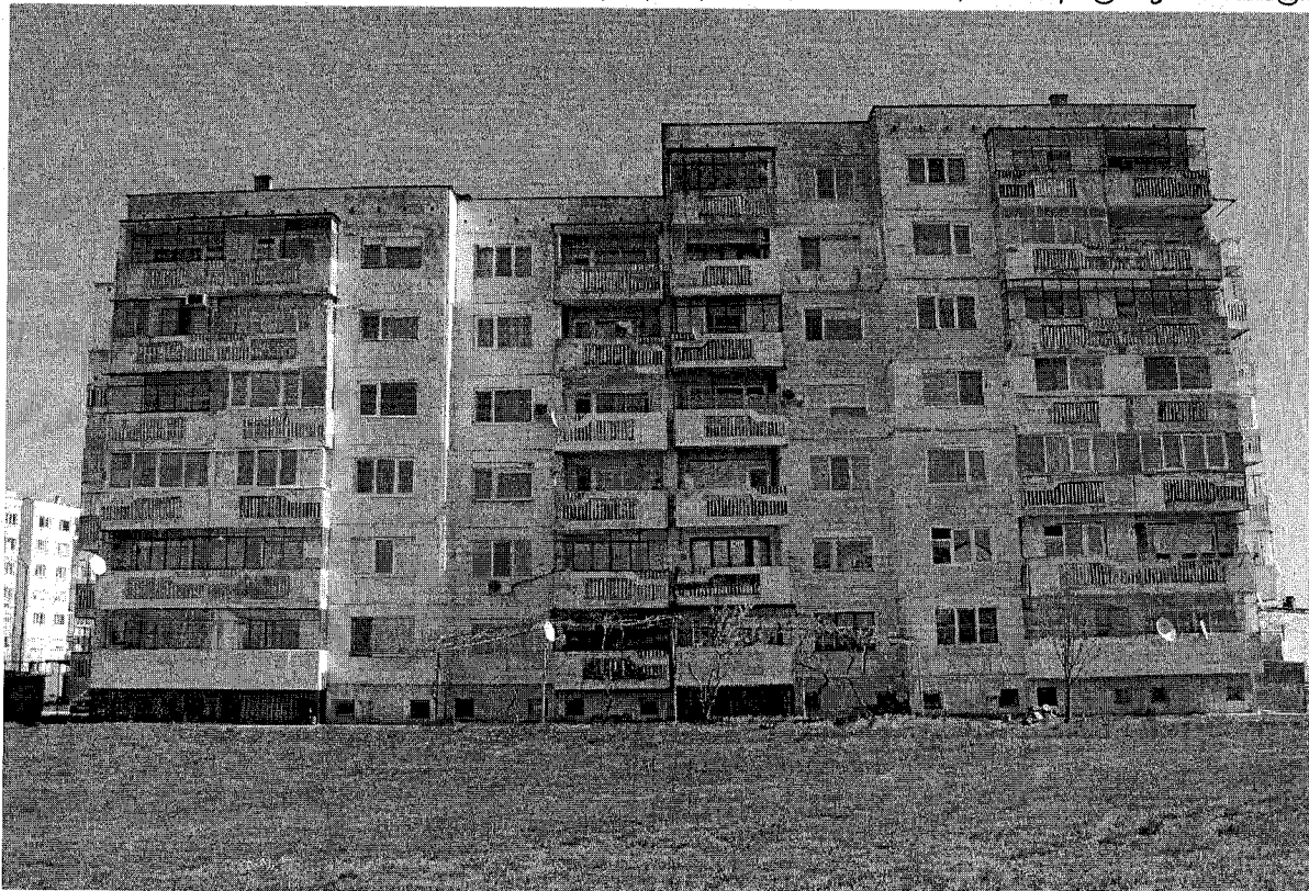
Югозападна фасада – наличие на голям брой усвоени балкони (по всички фасади). Частично положена топлоизолация и подменена дограма.
